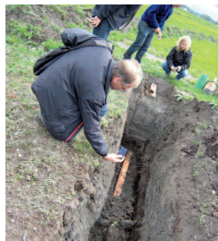
Abb. 2: Die fertig eingelegte Saugerleitung wird stufenweise eingedeckt. Mit dem Laser-Gerät wird das Soll-Gefälle für den Einbau markiert.
